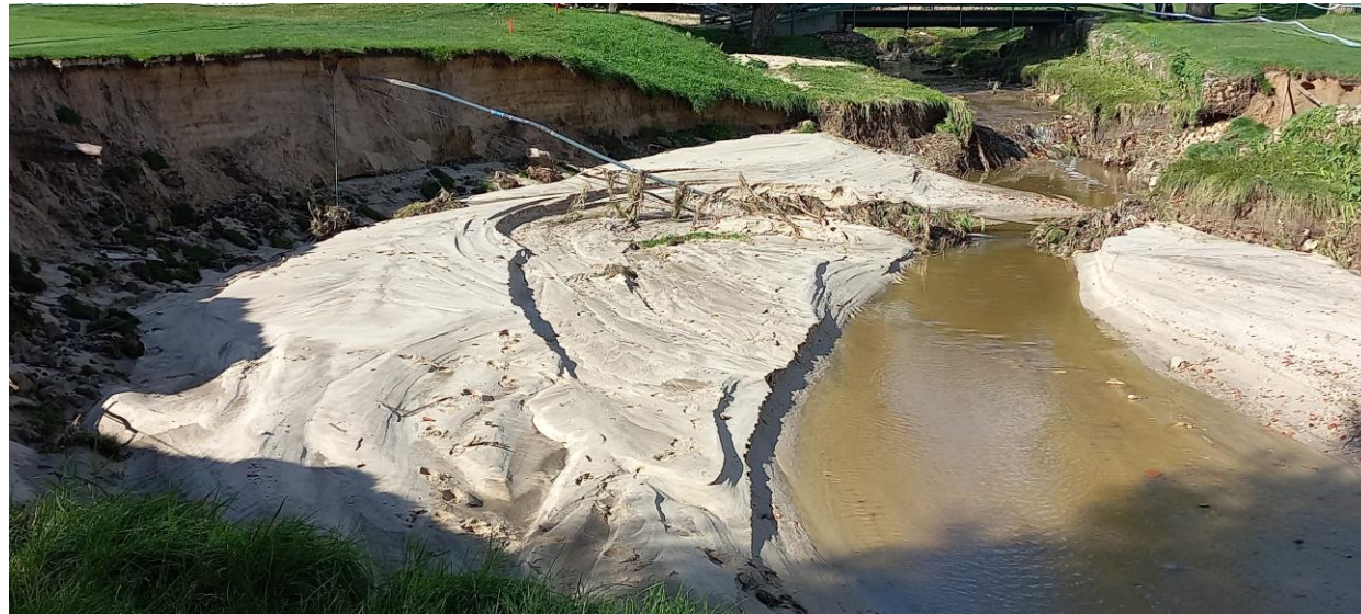
Figura 5. Erosión de la margen derecha tras la borrasca "Aline" de octubre
