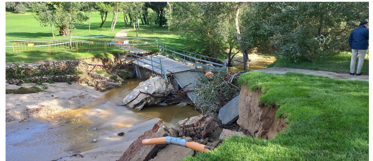
Figura 4. Situación de la pasarela tras la borrasca Aline de octubre
