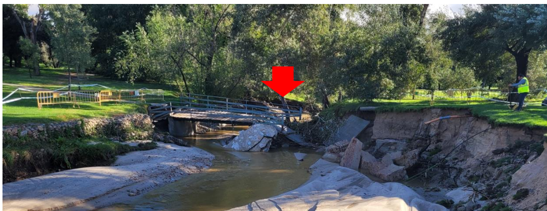
Figura 10. Posición del estribo exento en el interior del cauce por erosión del estrechamiento original
