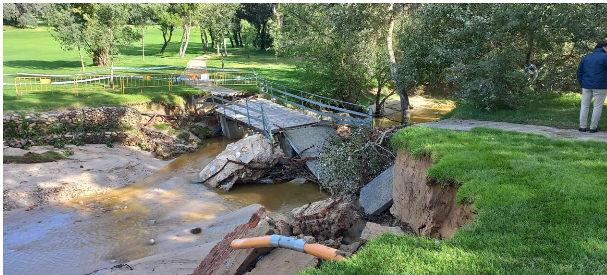
Fig. 3. Vista de la pasarela tras la borrasca Aline de octubre de 2024
