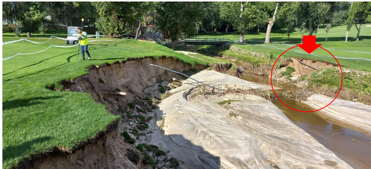
Figura 6. Rotura de gaviones aguas arriba
