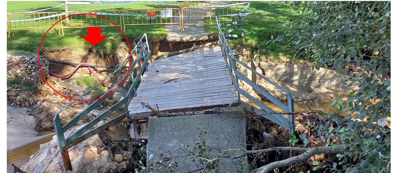
Figura 7. Rotura de gaviones junto a la pasarela
