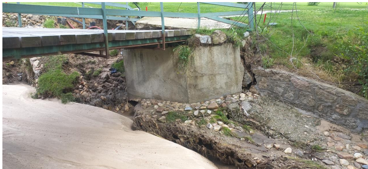
Figura 2. Situación de la pasarela tras la crecida de mayo de 2023.
