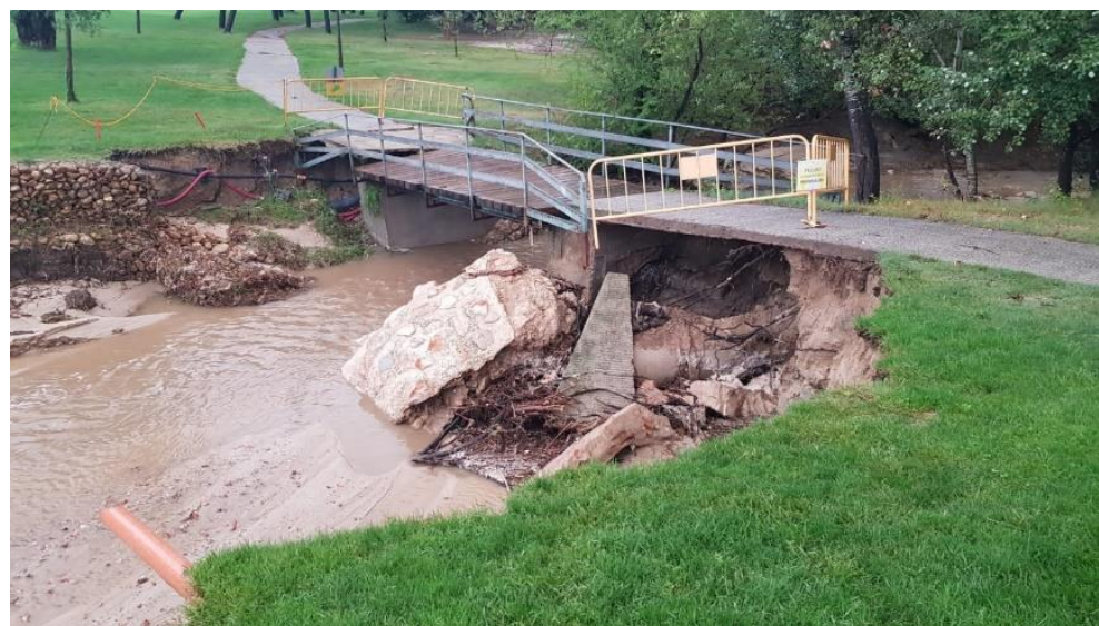
Figura 1. Situación de la pasarela peatonal tras la DANA (septiembre 2023)
