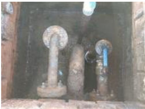
Arqueta tanque 2 - tuberías vista lateral
