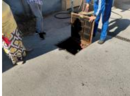
Arqueta tanque 2 - detalle conexiones
