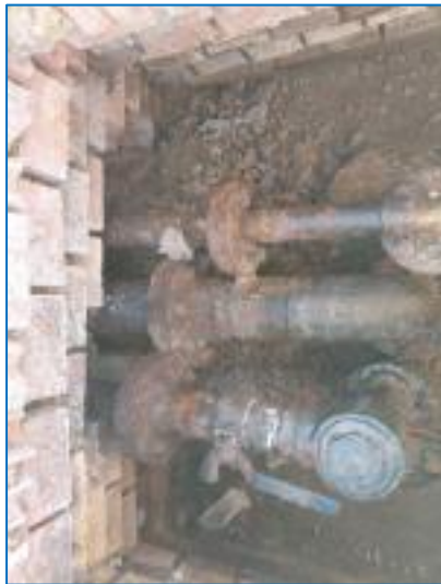
Arqueta tanque 1 - tuberías vista lateral
