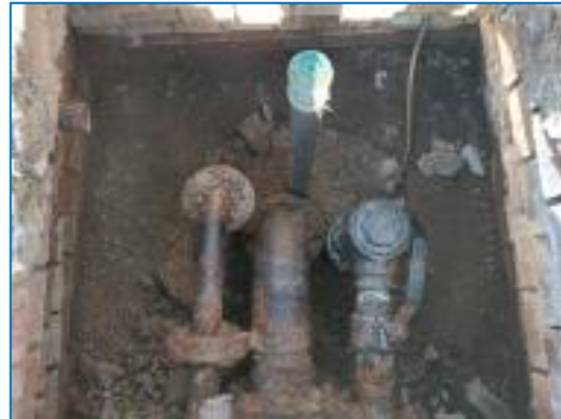
Arqueta tanque 1 - detalle conexiones
